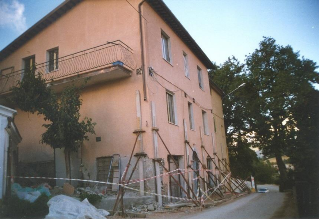
Fig. 4 – Edificio rinforzato con tiranti metallici disposti precedentemente all'evento sismico che in seguito lo ha interessato.
