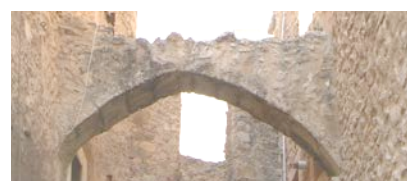
Figura 3. Esempi di archi di contrasto o a sbadacchio (San Pio delle Camere - AQ).
