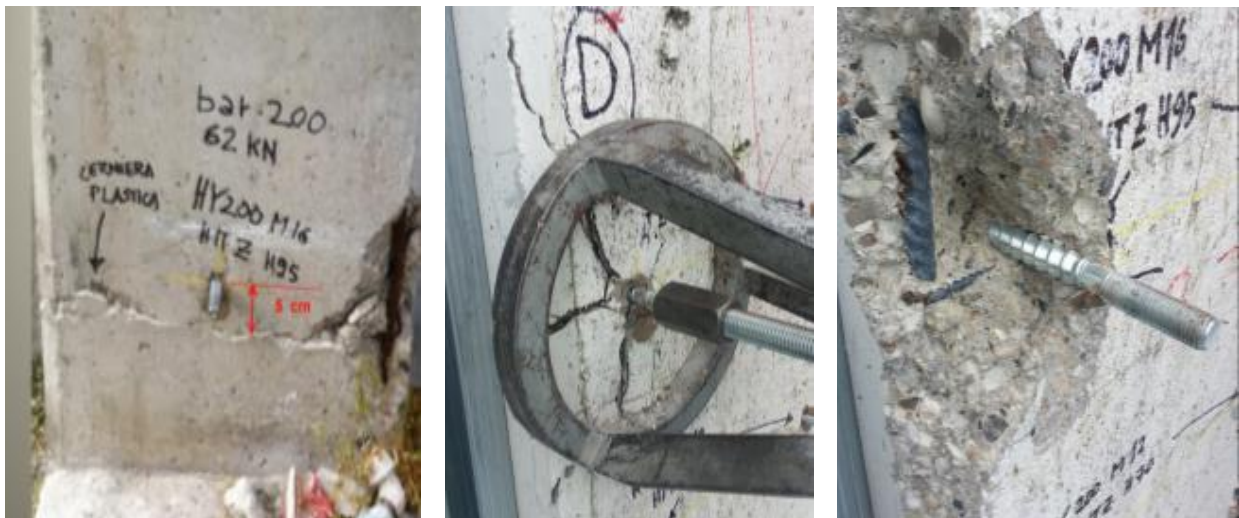
Fig. 6 – Prove di pull-out dell'ancorante chimico a controllo di coppia HIT-HY 200-A con barre HIT-Z su pilastri di un capannone industriale. Grazie alla conformazione tronco-conica della barra, il sistema mantiene un'elevata resistenza di estrazione anche a ridotte profondità. Scopri di più su HIT-Z https://www.hilti.it/sistemi-ancoraggio
