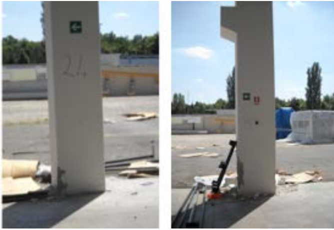
Figura 6. Plastizzazione dei pilastri alla base con fuori piombo residui
