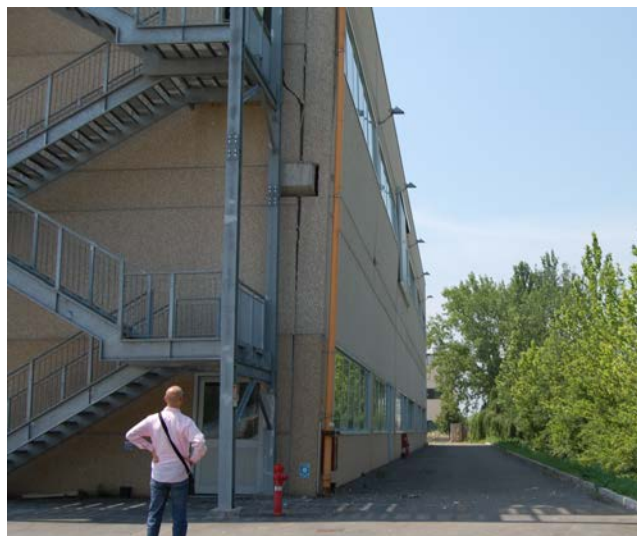
Figura 4. Danneggiamenti ai tamponamenti.
