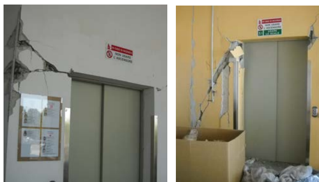
Figura 5. Danneggiamenti ai nuclei ascensore.
