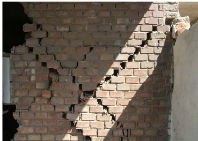
Figura 3. Crisi di un pannello murario di soli diatoni appartenente ad un edificio di tre piani. Si notino le lesioni di scorrimento passanti per i giunti di malta e la debolezza che, in questo caso, è costituita dall'interfaccia malta-laterizio dotata di poca aderenza.
