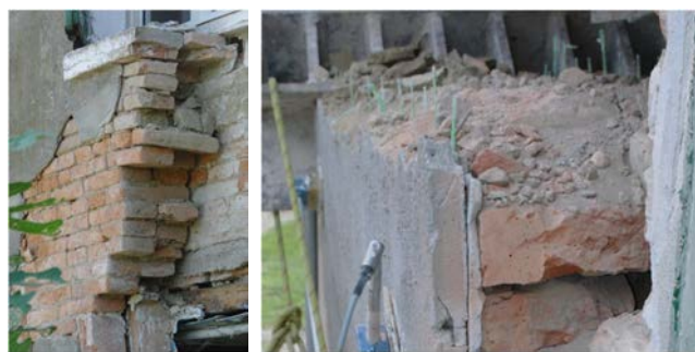
Figura 5. Dettagli del rinforzo applicato (intonaco armato con rete preformata in GFRP su entrambe le facce).
