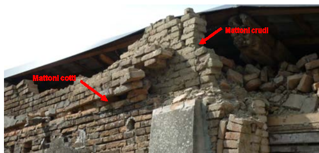
Figura 1. Il crollo ha messo in evidenza il paramento esterno in mattoni cotti (di colore tendente al rosso-arancione) e i mattoni crudi disposti sul paramento interno (di colore tendente al grigio-giallo).
