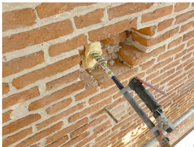
Figura 9. Tiranti: utilizzo di tessuto in acciaio STEEL 1800, arrotolato intorno alla catena, fissato adeguatamente, e successivamente iniettato con speciale miscela BFLUID X/B.
