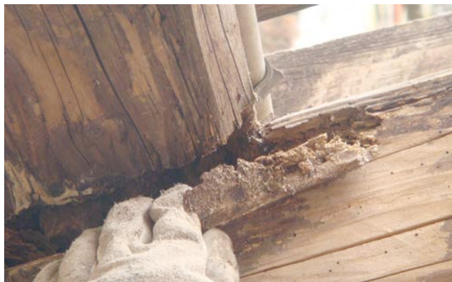
Figura 11. Capriata: degrado della struttura lignea.
