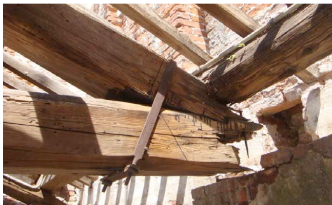
Figura 12. Capriata: degrado della struttura lignea.
