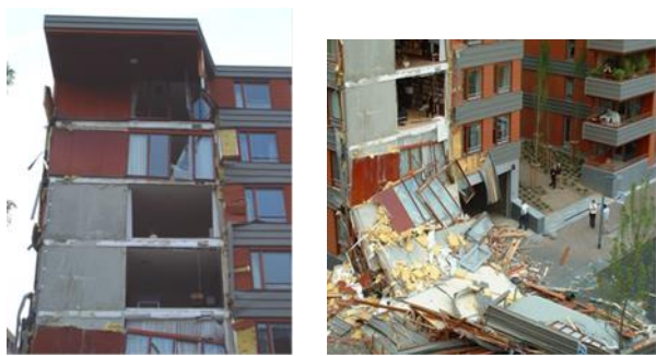
Fig. 5 – collasso progressivo di balconi di una struttura monolitica
