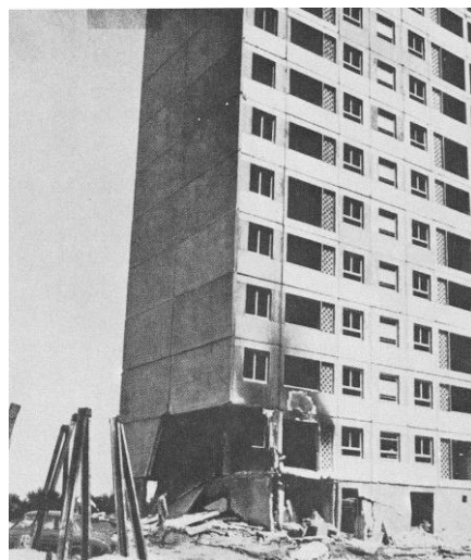
Fig. 6 – edificio dopo espulsione di due pannelli portanti d'angolo per esplosione di gas: la struttura restante è integra
