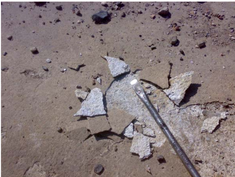
Foto 3 – Delaminazione di pavimento industriale (7 giorni)
