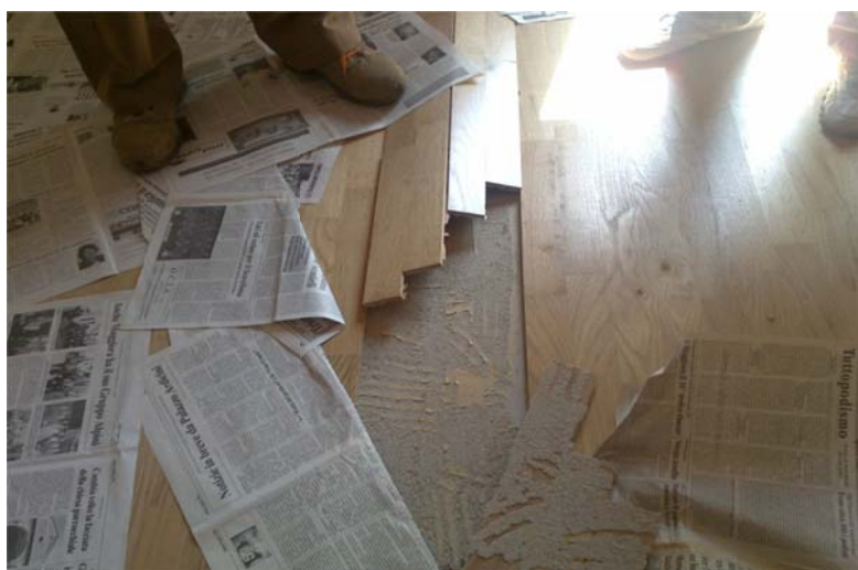
Foto 1- distacco del parquet a causa di eccessiva umidità (7 mesi)
