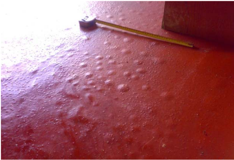
Foto 2 – Formazione di bolle per osmosi in un sistema resinoso (7 mesi)
