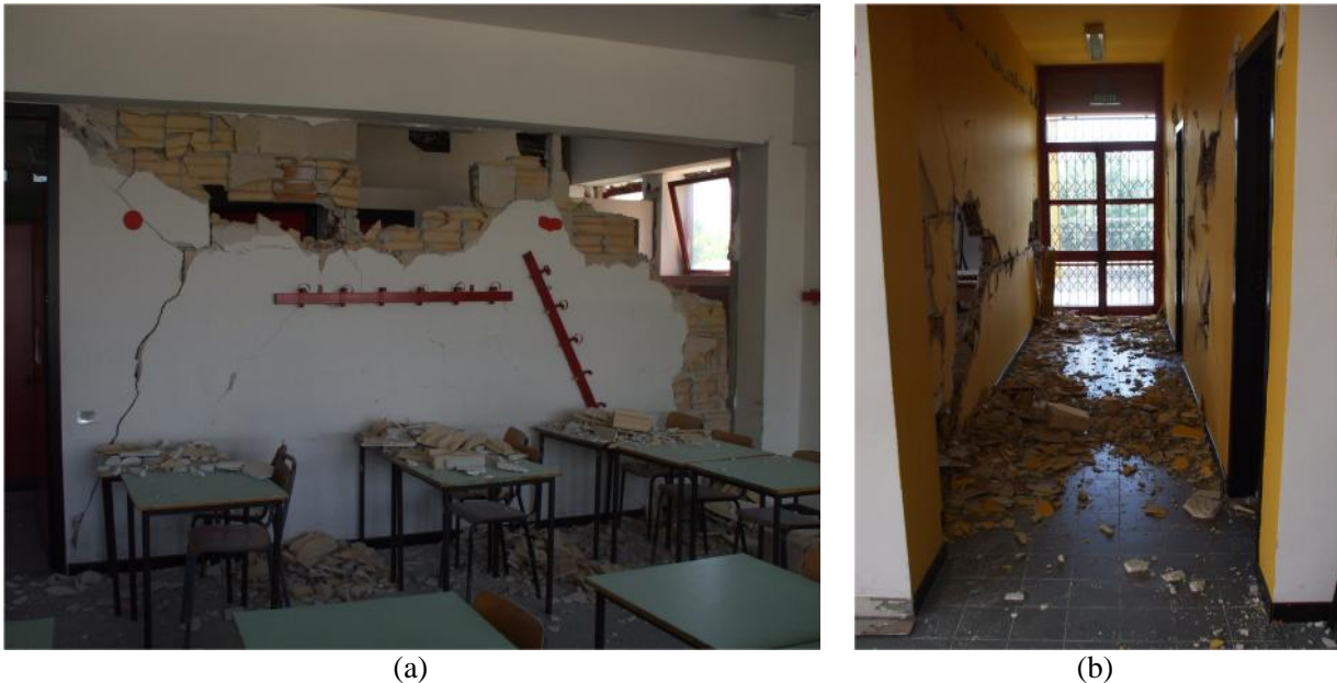
Figura 1. Esempio di crollo di tramezzature in una scuola in seguito al sisma dell'Aquila, (a) Aula (b) via di fuga
