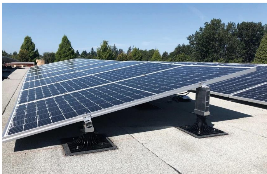
SOPRASOLAR FIX EVO TILT installato su copertura bituminosa
