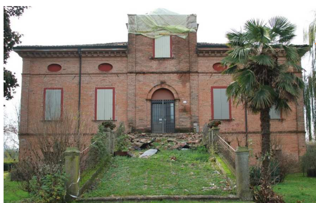
Figura 2: Facciata principale post sisma Crollo del timpano faccia vista e del pontile di collegamento tra la gradinata settecentesca e la porta d'ingresso
